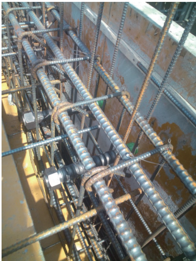
アンカーボルトの使用例
