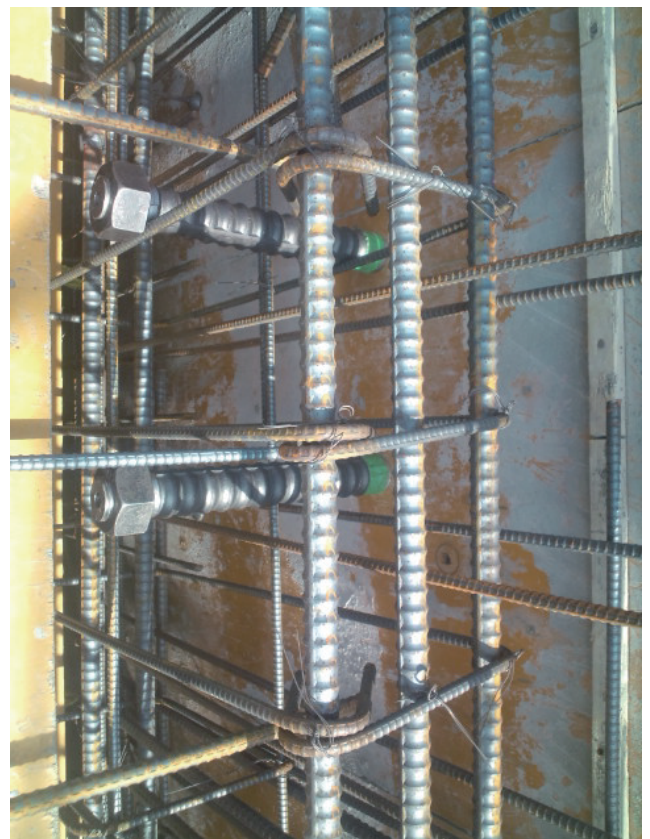
アンカーボルトの使用例
